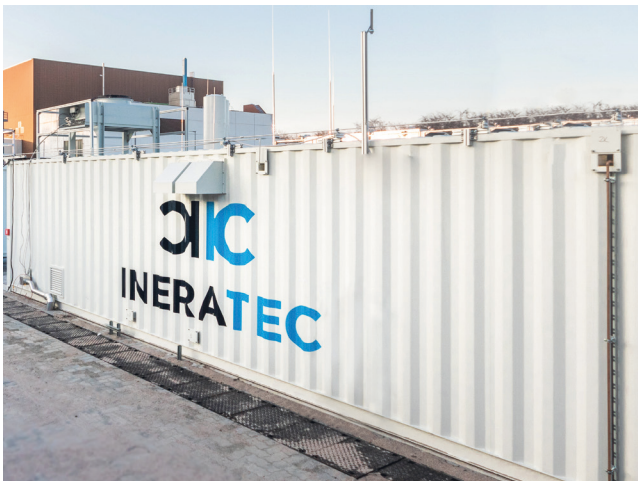
Abbildung 7: Containerbasierte Anlage zur Synthese von 200 bis 300 Liter Fischer-Tropsch-Produkt pro Tag aus CO 2 und Wasserstoff im Energy Lab 2.0 am Karlsruher Institut für Technologie (KIT). (Quelle: Ineratec GmbH)
